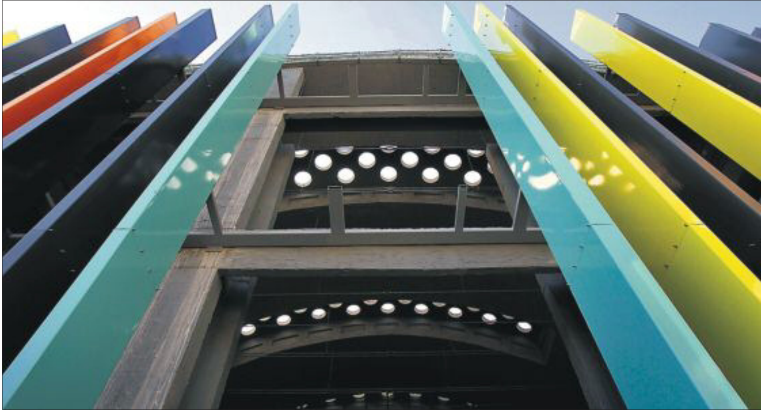
En la entrada de La Catedral de las Nuevas Tecnologías los arquitectos han colocado una colorida celosía vertical. /SAMUEL SÁNCHEZ
